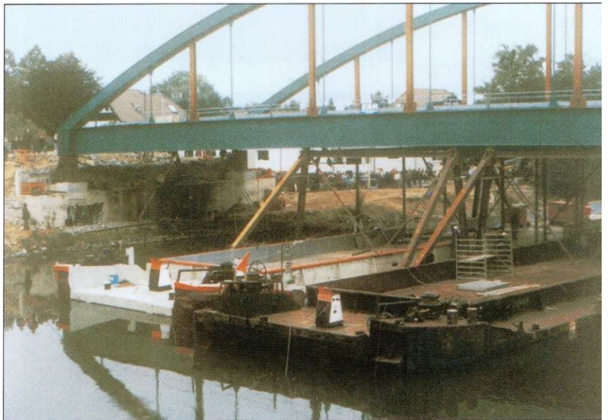
Zdjęcie 4: Przesunięcie poprzeczne mostu nr 441; a) plan sytuacyjny; b) przesunięcie poprzeczne
